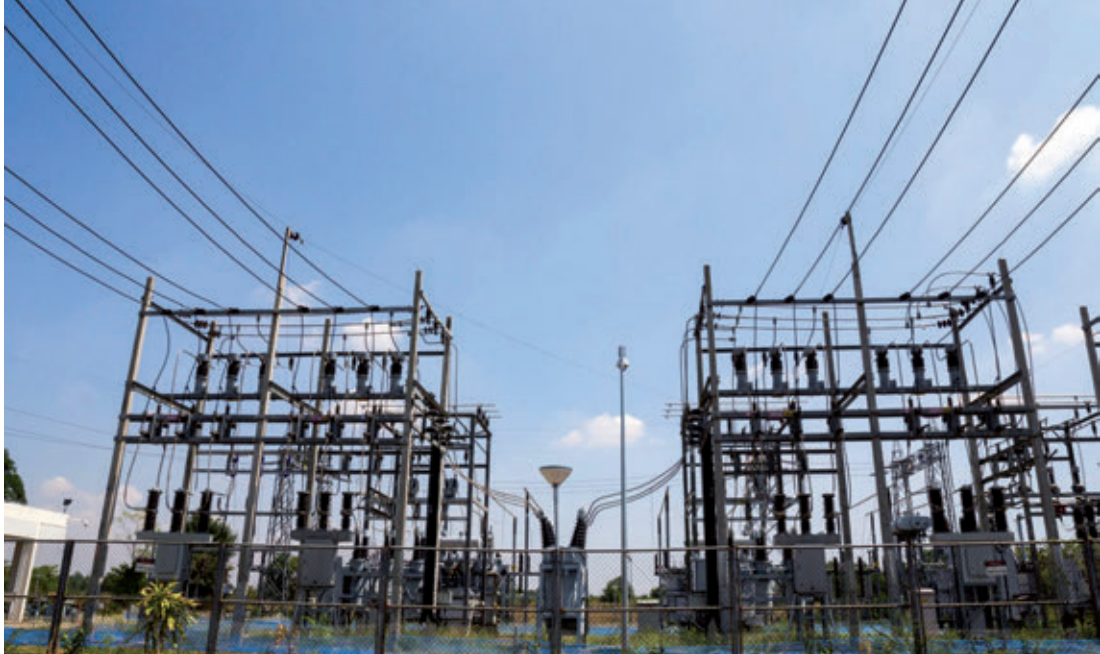
Subestación de 400 kV. 400 kV substation.
